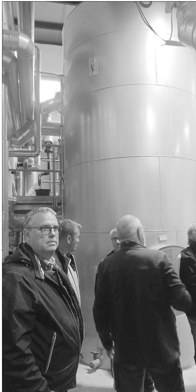
Im Hintergrund ein 15.000 Liter Pufferspeicher im Größenvergleich Foto: Aufn. K.Schmidt
