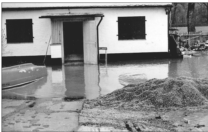
Nach dem Hochwasser, Wasser und Schlamm standen 80 cm hoch im Anglerheim
