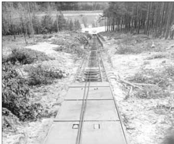
das Gegengewicht befindet sich oberhalb und die Aufzugsplattform in der Grube auf Ebene der Werkstrasse
