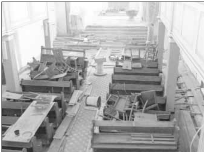
Baubedingtes Chaos in der Stadtkirche
