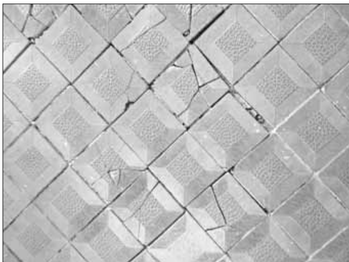
Schadhafte Fußbodenfliesen im Altarraum
