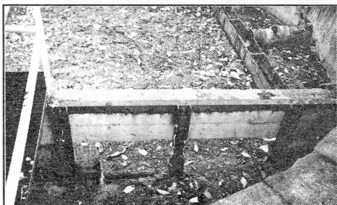
Emscher Brunnen zur »Abwasserklärung« Neubaugebiet Kahla
